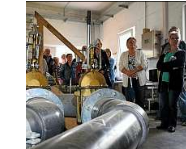
Blick in das Innenleben der Anlage.
